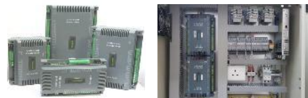
BMSシステム
