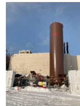
燃料転換(天然ガス化)による脱炭素への貢献
